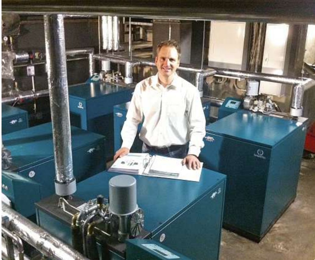
Nutzt seit Kurzem die Kraft-Wärme-Kopplung zur Strom- und Wärmeerzeugung im Betrieb: Die Metzgerei Häuser – hier Geschäftsführer Marco Häuser.
